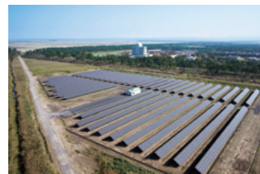
大潟村の太陽光発電 (提供：株式会社大潟共生自然エネルギー)
